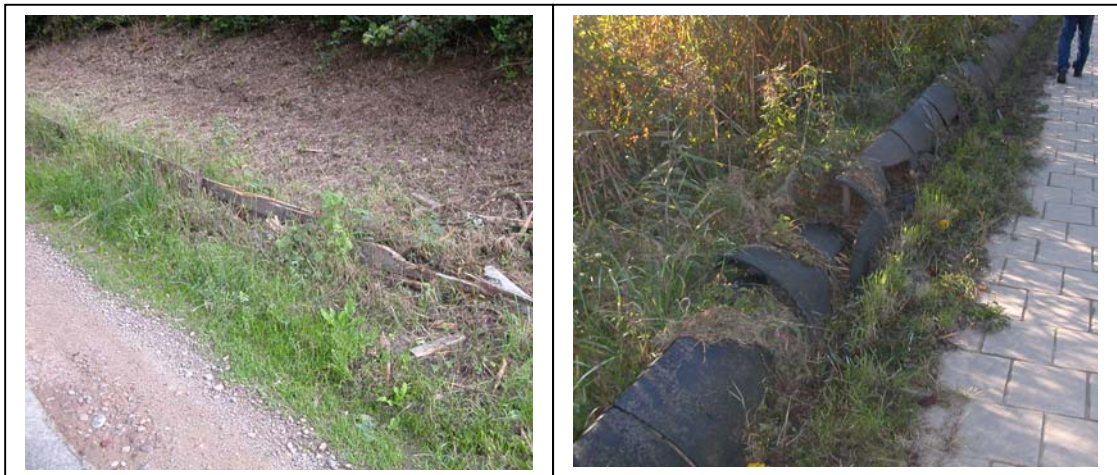
Foto's 18 & 19: Achterstallig onderhoud bij houten en kunststof geleidingswanden.
