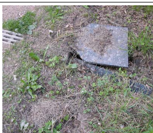
Foto 21: Achterstallig onderhoud van een aansluitpunt, waardoor de tunnel niet meer toegankelijk is
