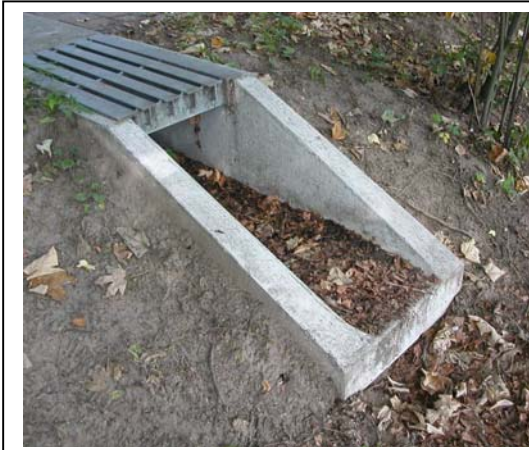
Foto 22: Achterstallig onderhoud bij de ingang van deze tunnel. De tunnelingang is niet te bereiken voor niet springende amfibieën (padden en salamanders)
