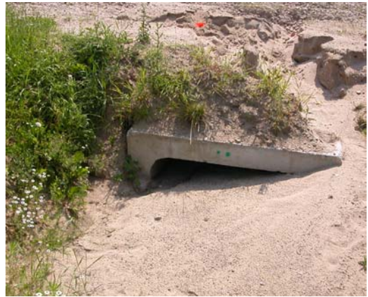
Foto 23: Tunnel is grotendeels dichtgeslibd met zand.
