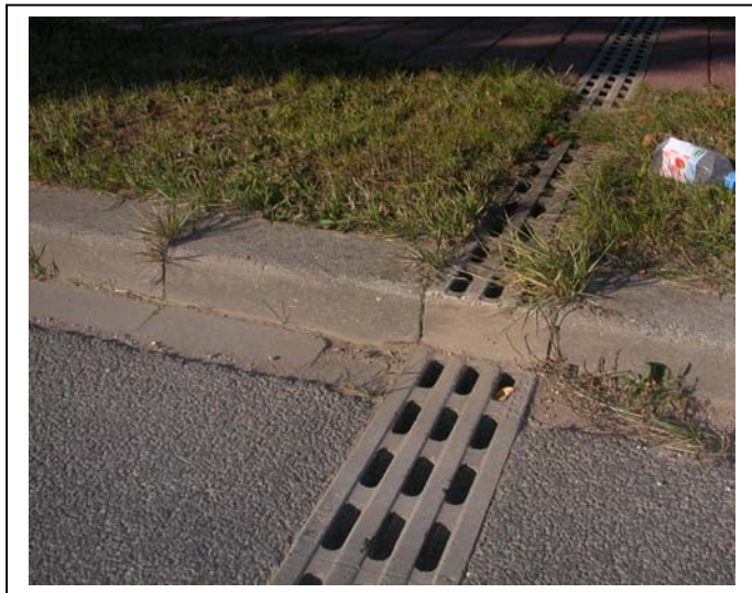
Foto 13: ongelijke aansluiting van tunnelementen bij een stoeprand.
