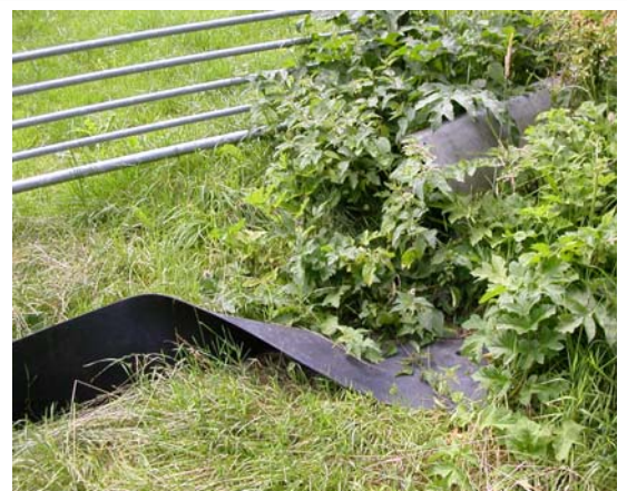
Foto 2: achterstallig onderhoud van een stopwand
